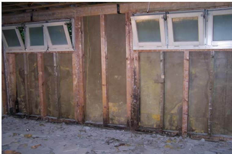
Schadhafte Außenwand durch Feuchtigkeit
